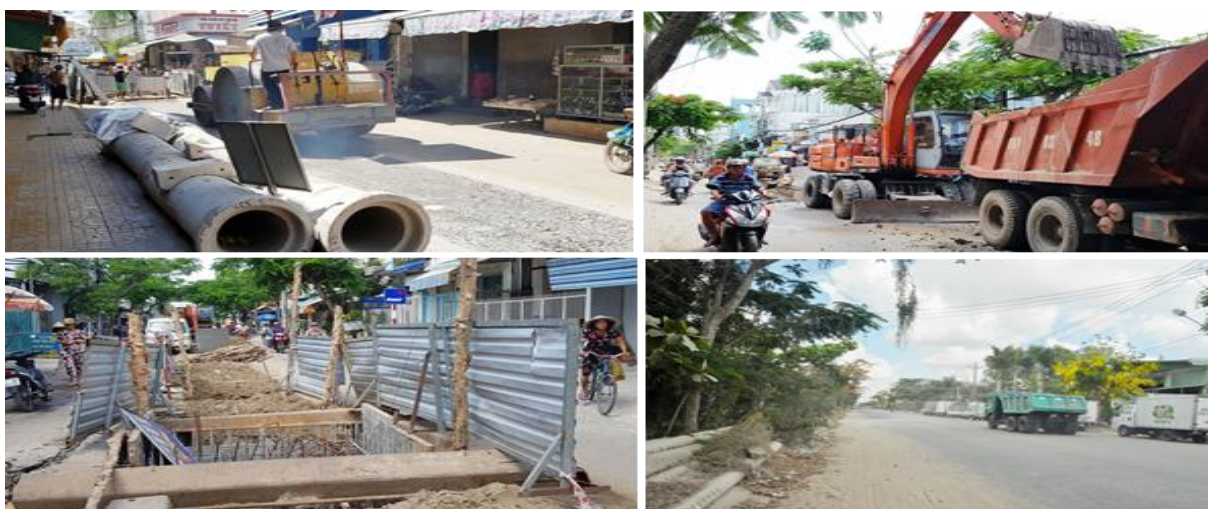
Hình 2.6. Ô nhiễm bụi tại các khu vực thi công dự án
